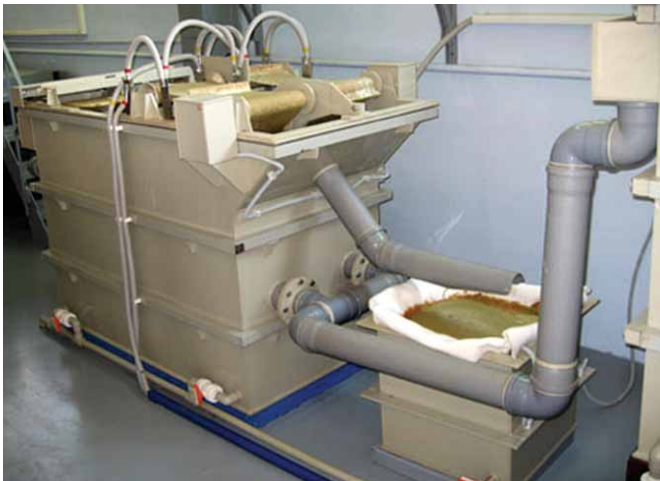
Рис. 2. Электрофлотатор производительностью 10 м 3 /час, г. Москва
