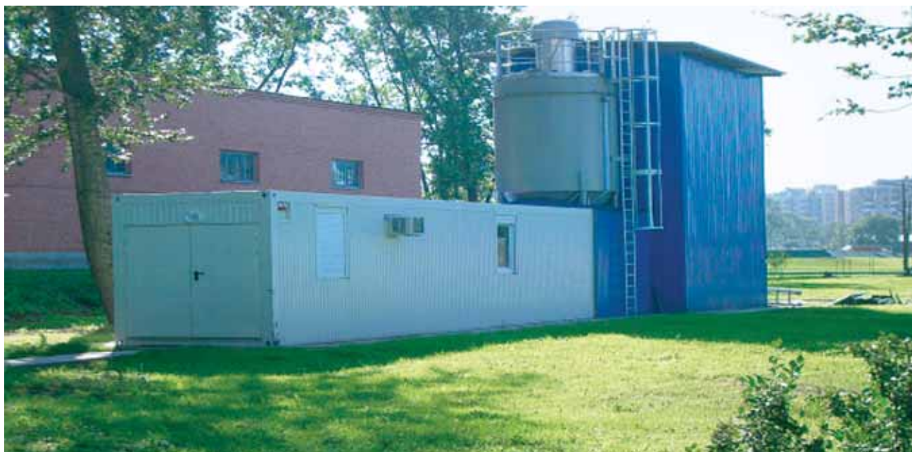
Рис. 7 Установка приготовления и дозирования ПАУ
